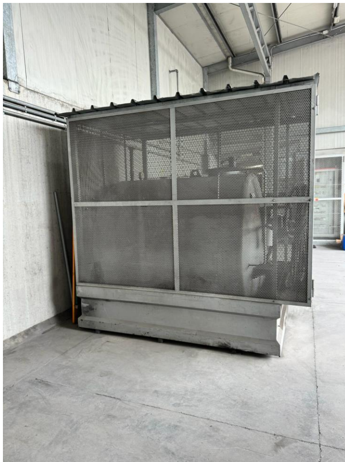
Cisterna di gasolio fuori terra in uso nell'impianto
